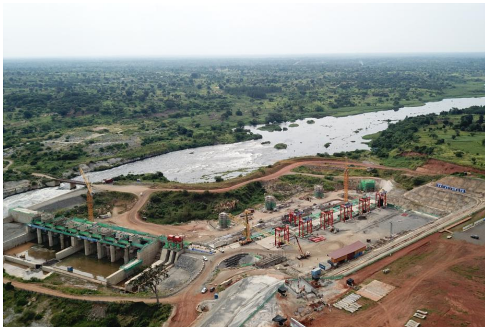
卡鲁玛水电站
